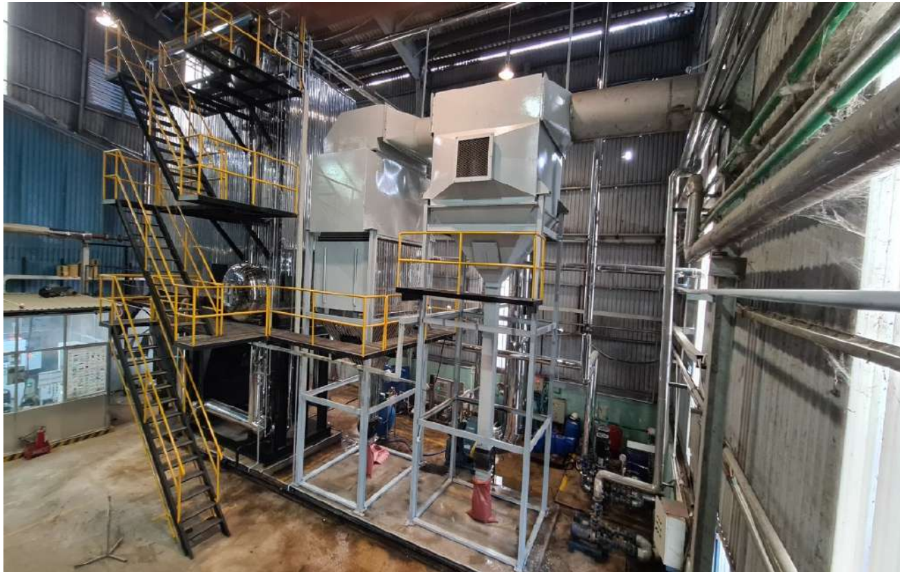
Dự án cung cấp hơi cho công ty cổ phần Betrimex
