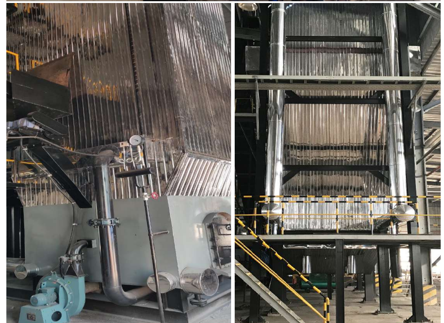
Dự án cung cấp hơi cho công ty NFC (Natural Food Company)
