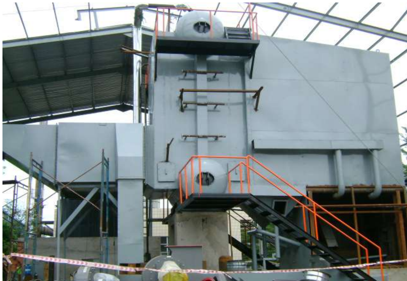
Dự án cung cấp hơi cho công ty cổ phần giấy Minh Phúc
