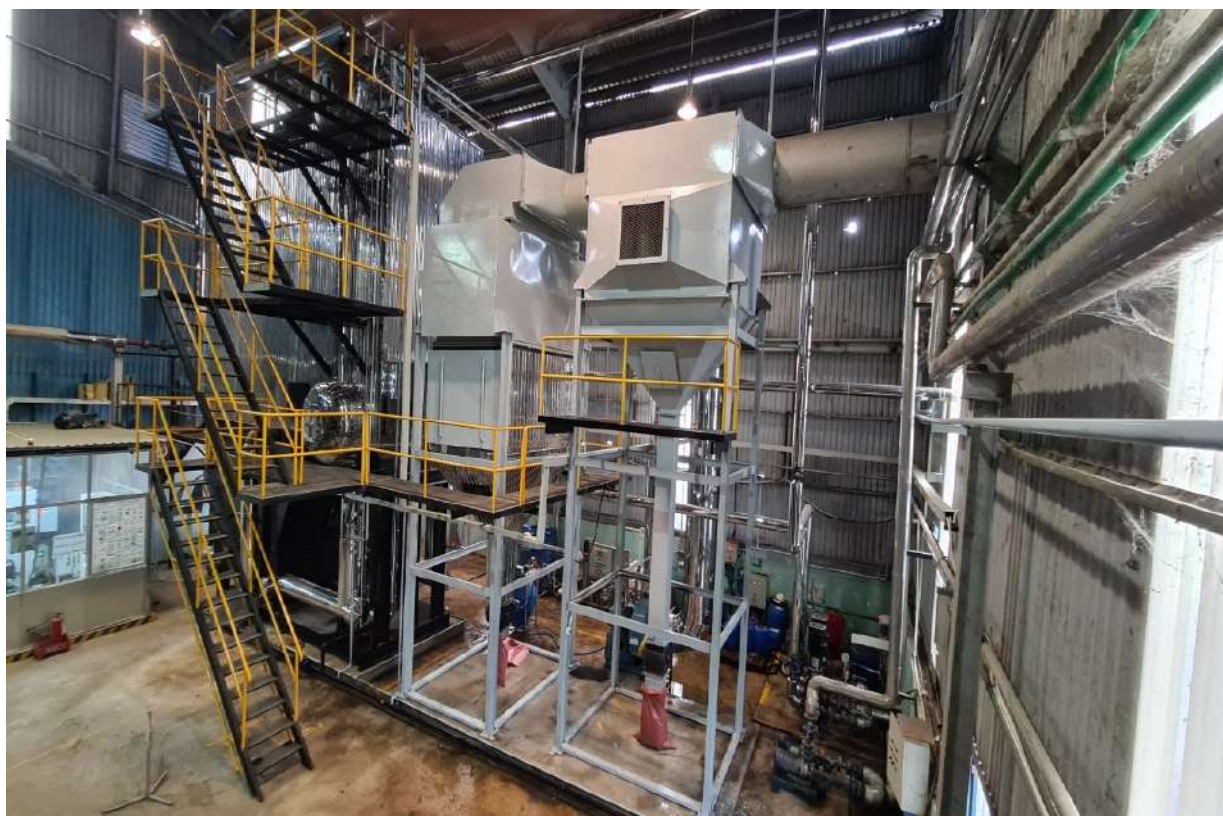
Dự án cung cấp hơi cho công ty cổ phần Betrimex
