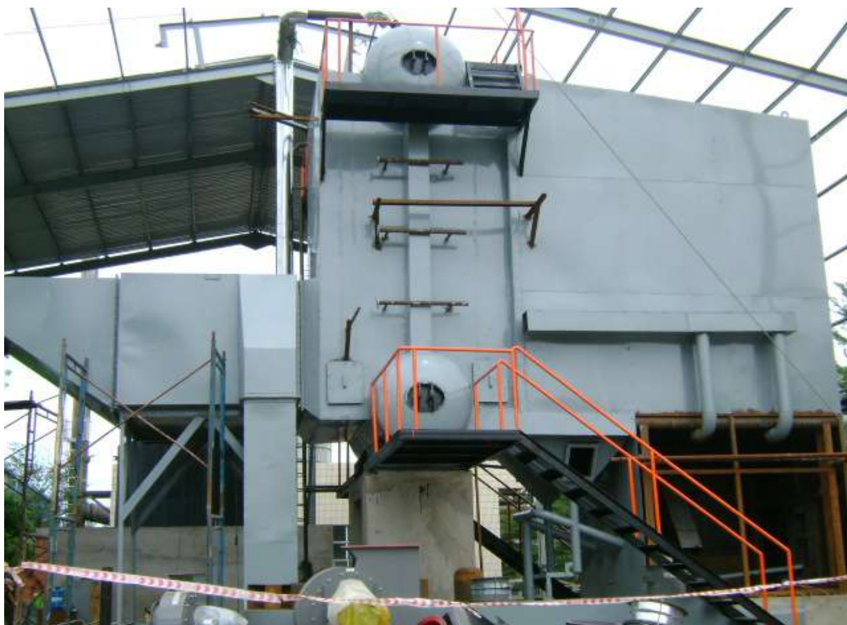
Dự án cung cấp hơi cho công ty cổ phần giấy Minh Phúc
