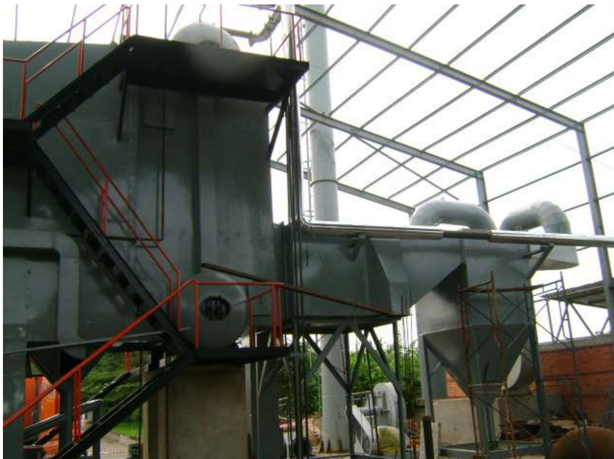
Dự án cung cấp hơi cho công ty CP giấy bao bì Vina Toyo
